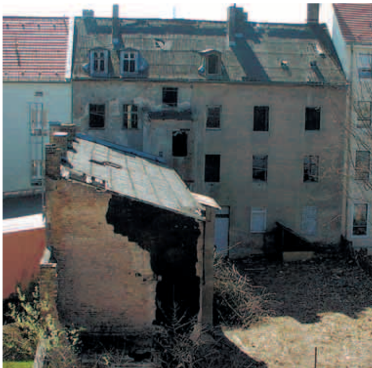
Ruine Nur noch abrisstauglich schien das denkmalgeschützte Mehrfamilienhaus samt aufgerissenem Hofgebäude
